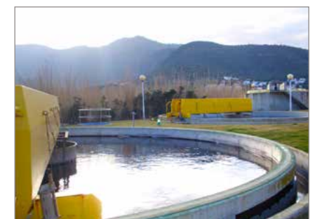
Abwasserbehandlung zur Wasserwiederverwendung Wastewater treatment for water reuse
