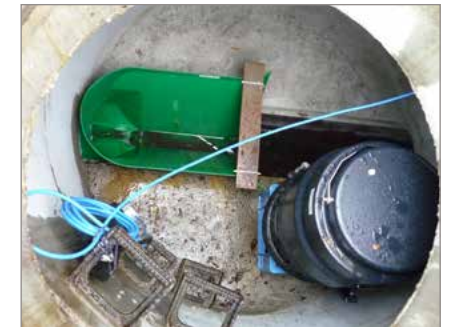
Monitoring Regenwasserabfluss im Straßenablaufschacht Monitoring of roadway runoffs in road gully
