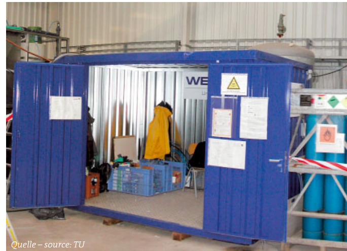
Versuchsanlage am Standort des Klärwerks Test plant at WWTP site
