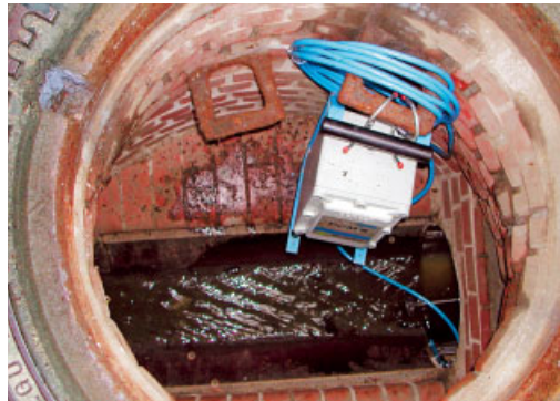
Durchflussmessung im Abwasserkanal – Flow-through measurements in a sewer
