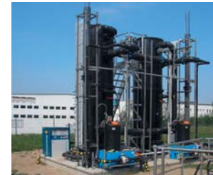
Raumfiltrationsanlage Klärwerk Münchehofe Filtration plant at WWTP Muenchehofe
