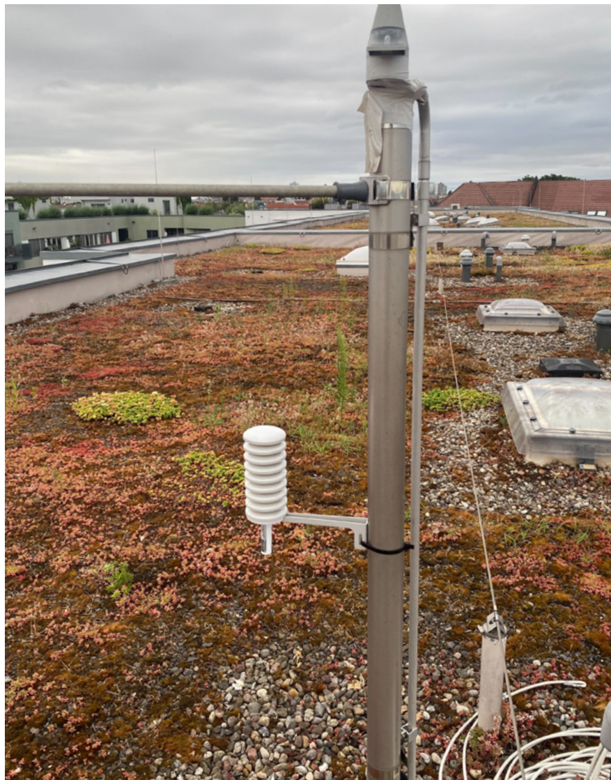
LoRaWAN-Temperatursensor auf extensivem Gründach
