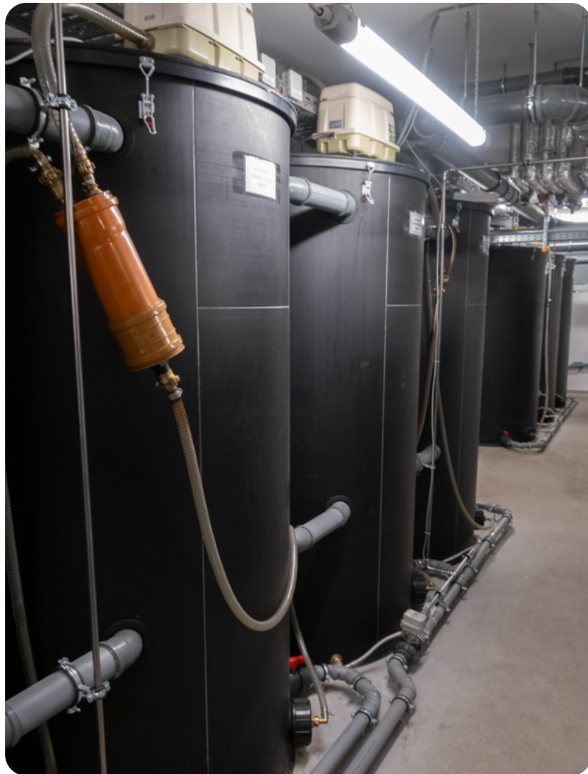
Grauwasserrecycling-Anlage in einer Studierenden-Apartmentanlage der Berlinovo
