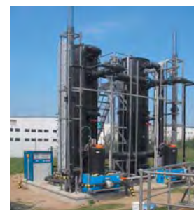
Raumfiltrationsanlage Klärwerk Münchehofe Filtration plant at WWTP Muenchehofe
