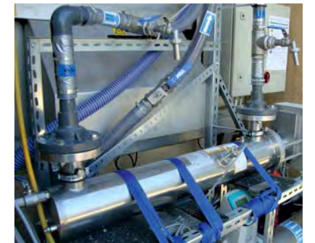
UV-Desinfektion nach Mikrosiebung UV-disinfection after microsiebe
