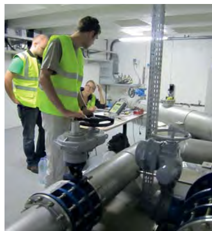
Energieaudit für Brunnen Energy audit for wells
