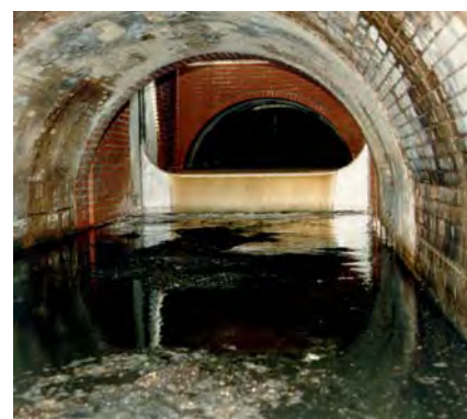
Stauwehr zur Mischwasserbewirtschaftung Weir for CSO management
